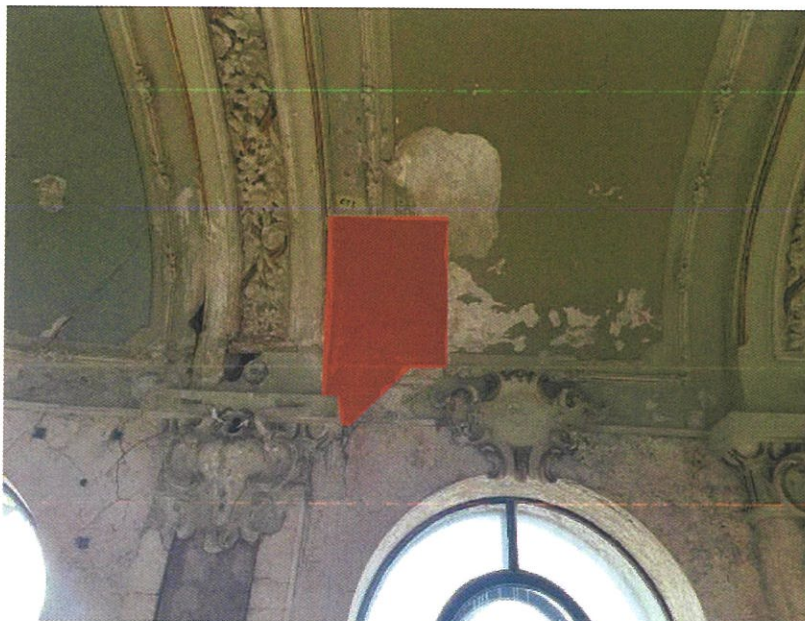
Foto 06. În zona unde a fost extras fragmentul decorativ (cornișă aulă), în scopul de a se analiza starea de conservare a șarpantei acoperișului, se vor face intervenții preventive de biocidare a elementelor din lemn și ipsos și se va capsula zona respectivă pentru a nu se extinde atacul biologic.
