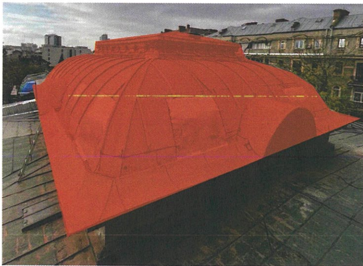
Foto 11. Se mențin lucrările provizorii de acoperire pe zonele identificate, eliminarea acestora pe perioada iernii punând în pericol.
