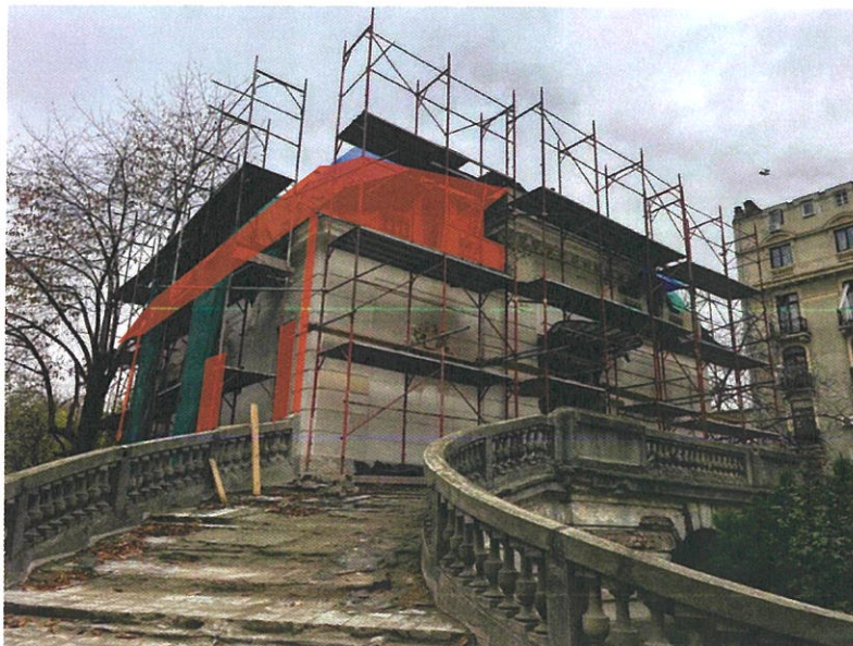
Foto 16. Se va menține schela metalică exterioară, în vederea montării protecției la învelitoare.
